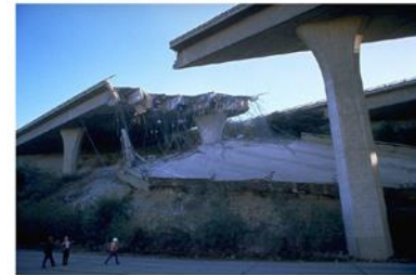
Terremoto de Northridge de 1994 (Los Ángeles) la Causó 72 muertos, 12.000 heridos
